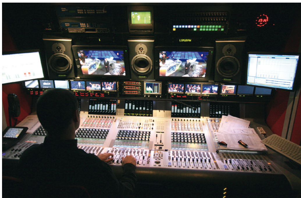
La régie son du car Millenium Signature 11 AMP Visual équipée d'une console Studer Vista 8.
