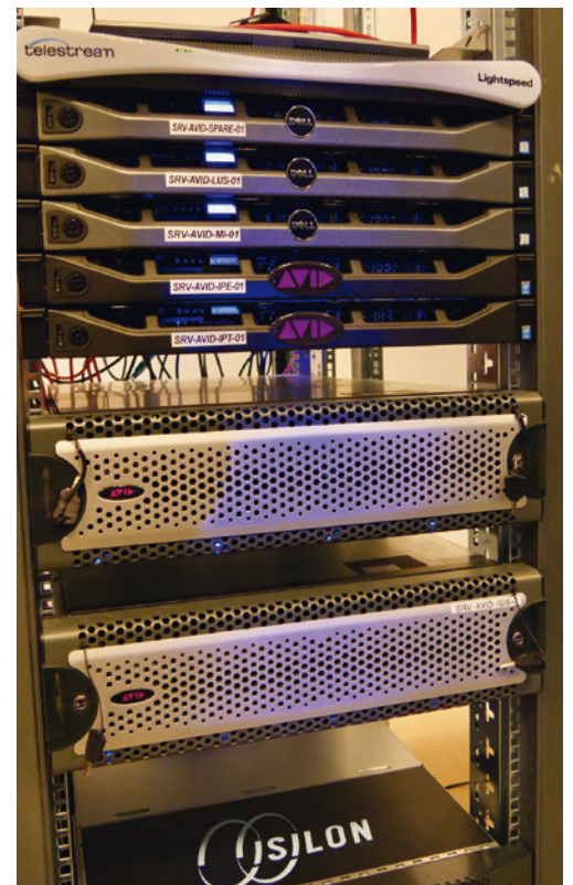
ISIS 5500 de 2 x 64 To, AirSpeed 5500 et Avid Interplay sont quelques unes des briques de la nouvelle installation.
