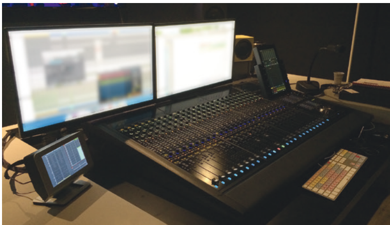
L'un des douze studios son d'Éliote : le monitoring comprend des Genelec-8030a DSP et Avantone en petites écoutes. Installée en 2015, la nouvelle surface Avid S6 M10 en version 24 faders pilote ici un Pro Tools HDX.
