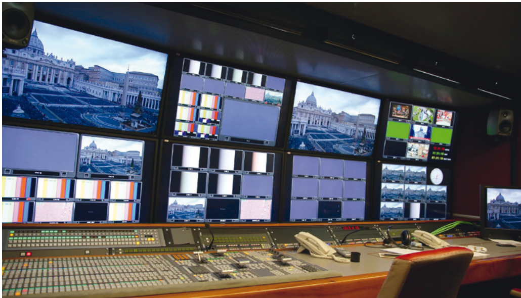
Le car final de CTV qui a servi à la réalisation du direct en UHD.
