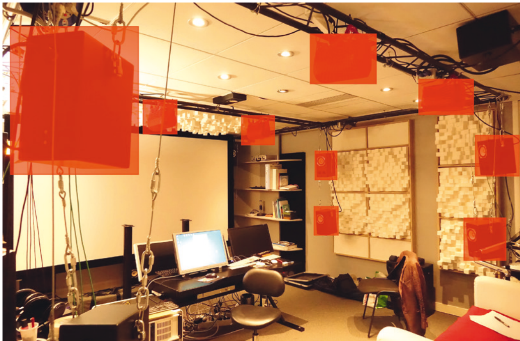
Mise en évidence des aménagements effectués dans l'auditorium 22.2 de France Télévisions pour les besoins du test. En rouge les enceintes utilisées forment un dispositif utilisant quatre enceintes sur trois couches : base, hauteur et plafond.
