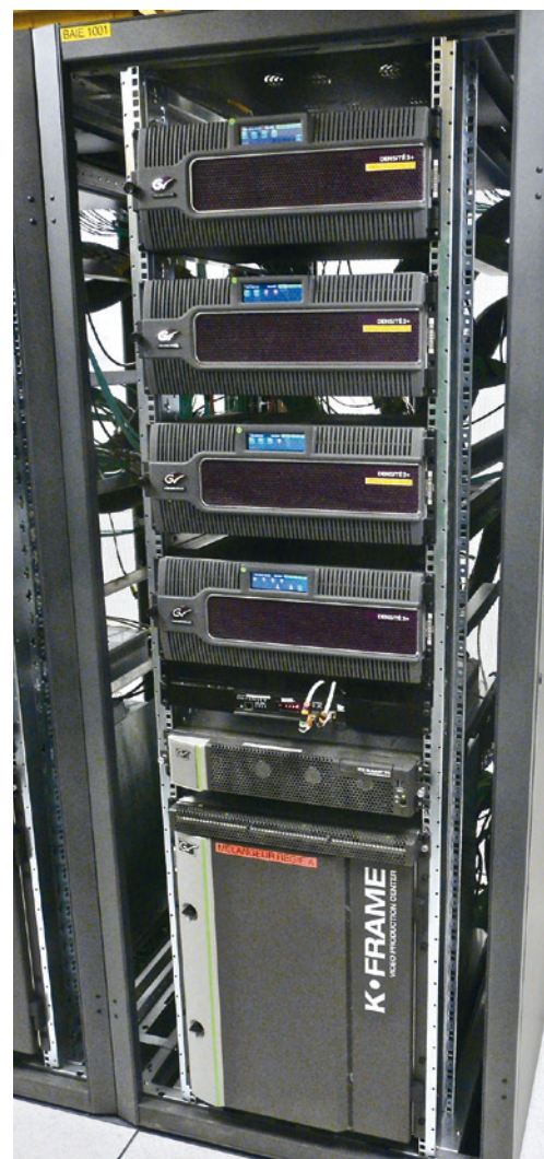
L'unité de traitement K-Frame du mélangeur Kayenne avec en partie haute les châssis Densité de Grass Valley équipés des cartes de conversion SDI/IP IPG-3901. © PA Taurfour
