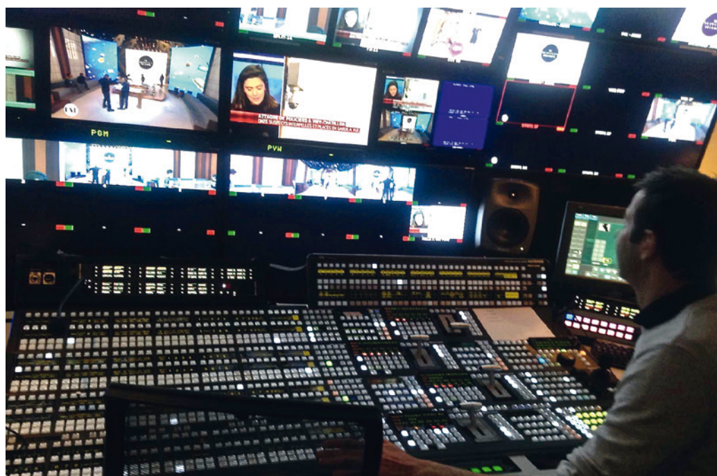
Le mélangeur Kayenne de Grass Valley est au centre des deux nouvelles régies des studios A et B.
