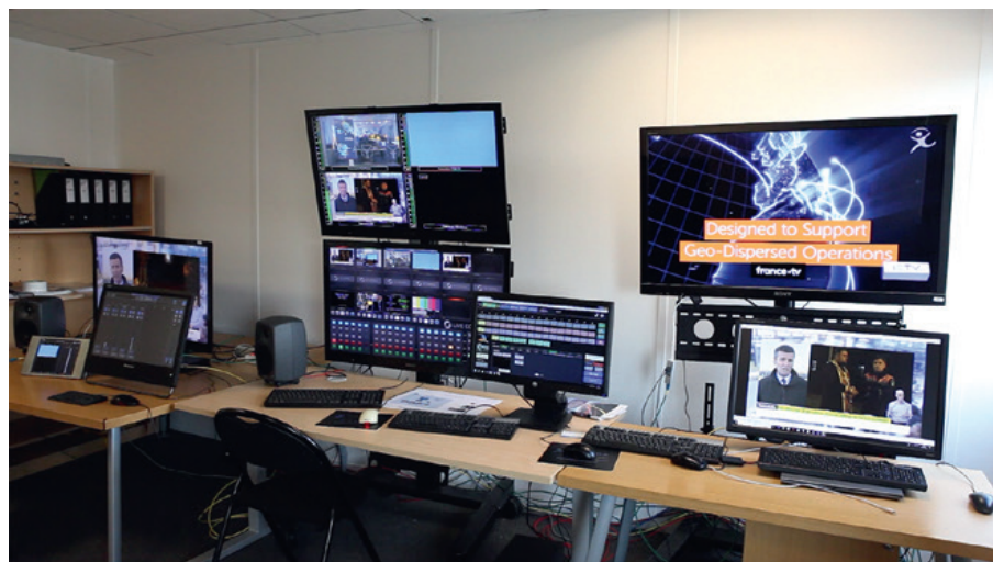
En régie, les équipements sont exploités depuis des postes informatiques. À gauche, l'écran tactile de contrôle de la console audio Lawo, au centre le mélangeur vidéo Live Compositor de ChyronHego et à droite le système de playout Versio d'Imagine Communications.
